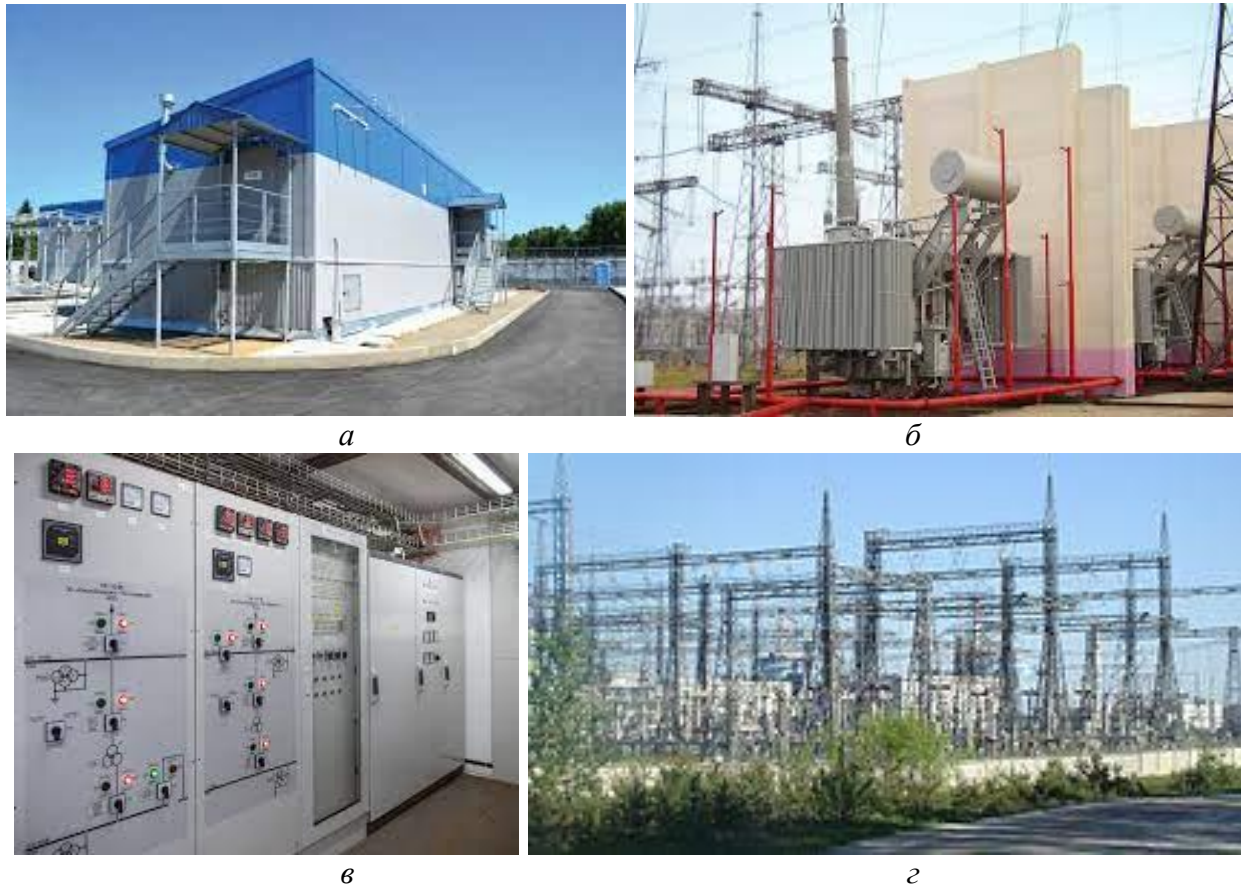
Рис. 1.9. Характерні елементи підстанцій: а – загальнопідстанційний пункт керування; б – шунтуючий реактор; в – релейний захист; г – відкриті розподільчі пристрої
