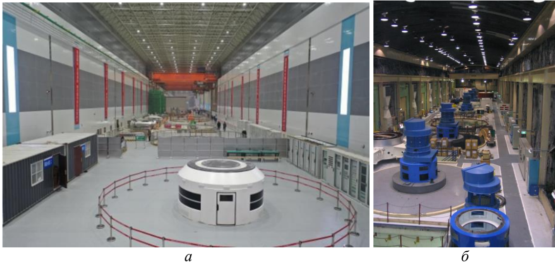
Рис.3.8. Електростанції: а – насосна акумулююча електростанція “Fengning” (Китай) потужністю 3,6 ГВт; б – “Manapouri” із встановленою потужністю 854 МВ (Нова Зеландія)
